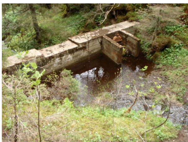
Figur 29. Inntaksdam med ventil i Svarttjønnbekken
